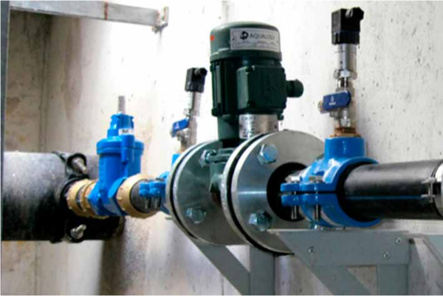
Micro-turbina en tubería. Fuente: aqualogy.net
